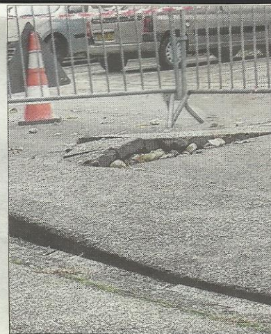
■ Chemin de Terrasson, la chaussée s'est décollée. Photo Christian GIL
