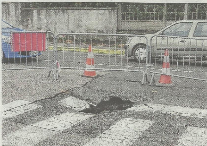
■ La chaussée s'est carrément effondrée, au carrefour du boulevard Fayol et du chemin de Terrasson. Photo Christian GIL
